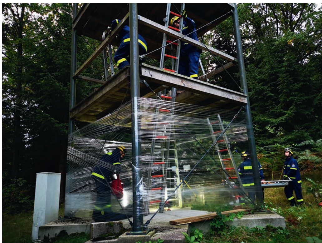
Im Kellergeschoss (folienverpackter Teil des Übungsturmes) und im nächsten Stock sind die Einsatzkräfte am Arbeiten. Fotos: Stefan Barth
